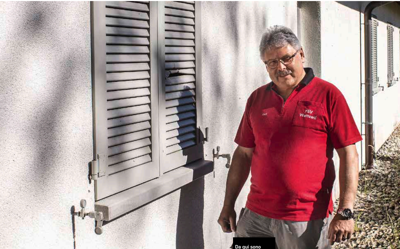
Da qui sono entrati i ladri: il presidente Dieter Rothacher davanti alle imposte e finestre forzate del poligono di tiro.
