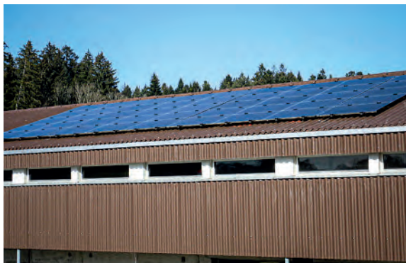
Une nouvelle installation solaire a été installée sur le toit du stand de tir.
